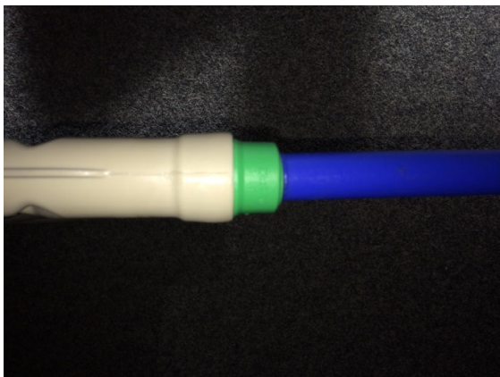
Schweißverbindung vom Absorber (muffenseitig) mit Reduziermuffe DN 32 auf DN 20 und angeschweißtem DN 20 Rohr (für Anbindung an Soleverteiler)
